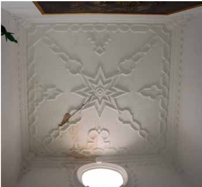
Ilustración 22. Bóveda de la escalera del Palacio de la Familia Álvarez Pimentel (Fotografía A. Aguayo)
